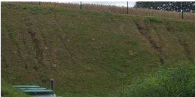
Zone de ravinement
